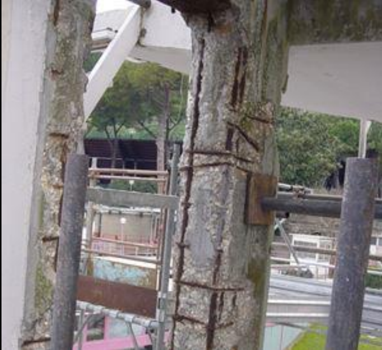
PISCINA ESTERNA – IL TRAMPOLINO – FORO ITALICO. PROBLEMI DI CONSERVAZIONE
